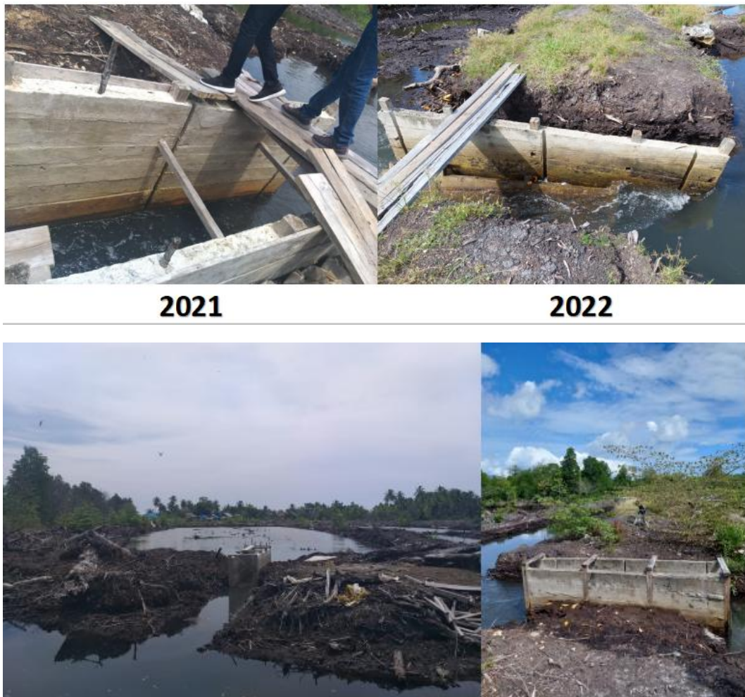
Gambar 5.3. Kondisi pintu air di saluran sekunder dan pintu air di petakan tambak.
